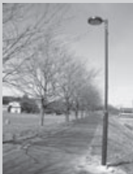
上小鴨 自転車道防犯灯設備 自転車道(旧倉吉線跡地)に防 犯灯が6基設置され、防犯や 交通安全に役立っています。
